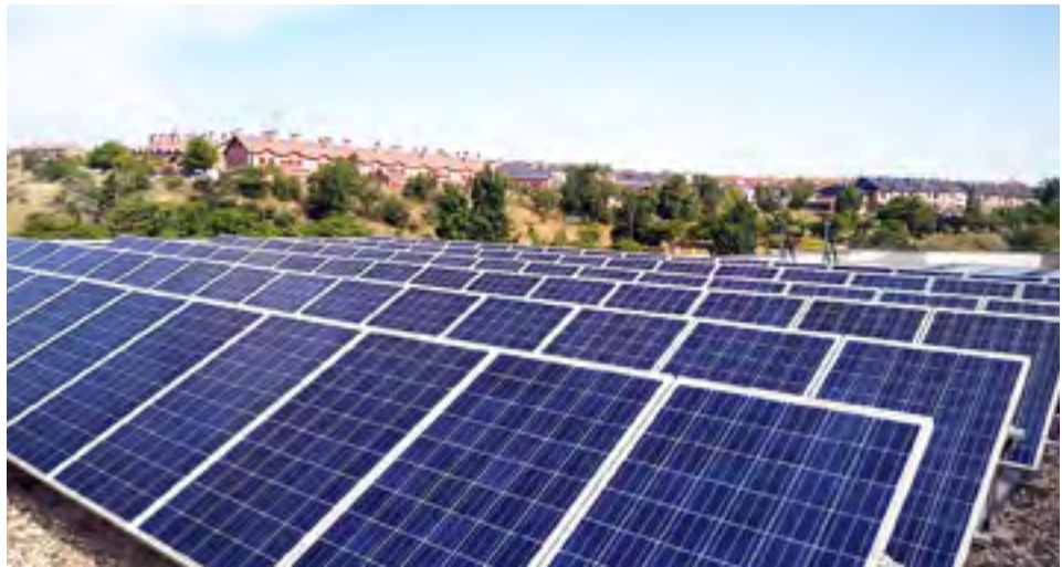
Paneles fotovoltaicos instalados en Complejo Asistencial Benito Menni (Ciempozuelos).
